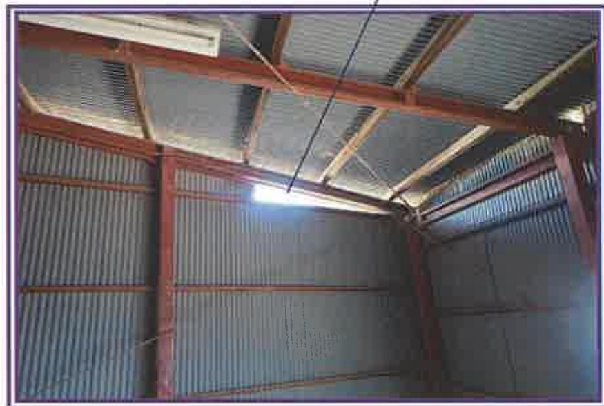
外壁の欠損箇所を撮影したもの(物件2主である建物)
