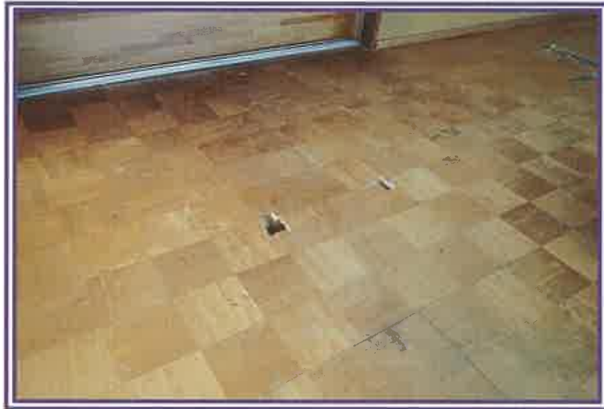
床の損傷箇所を撮影したもの(物件2附属建物符号1の作業室1)
