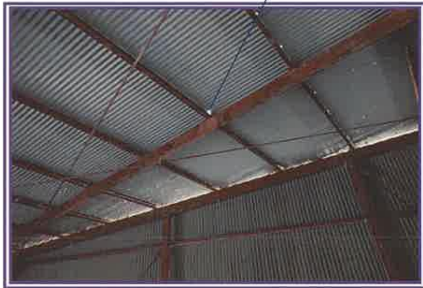
屋根の損傷箇所を撮影したもの(物件2主である建物)
