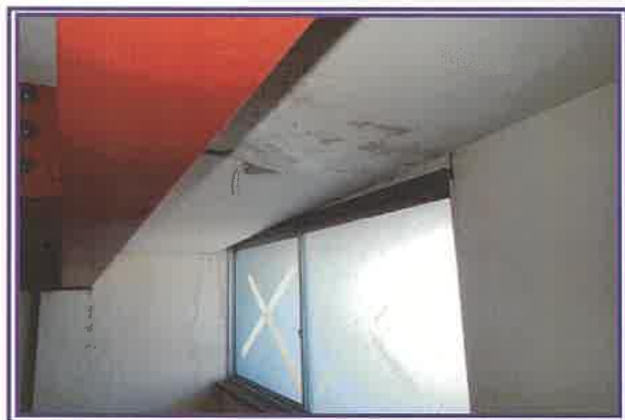
雨漏り跡が認められる状況を撮影したもの(物件2附属建物符号1の2階倉庫2)
