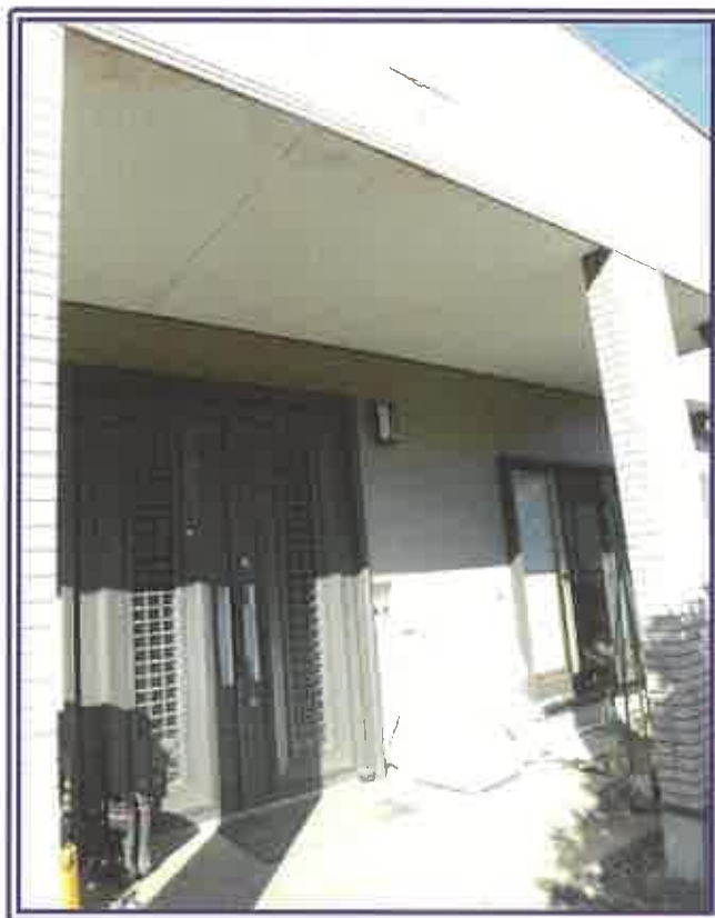
玄関前の状況（バルコニー床板の縁に雨漏りによるシミあり）
