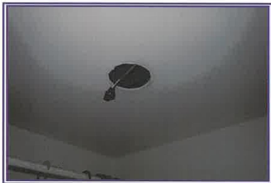
洗面室の照明器具が取り外されている状況を撮影したもの
