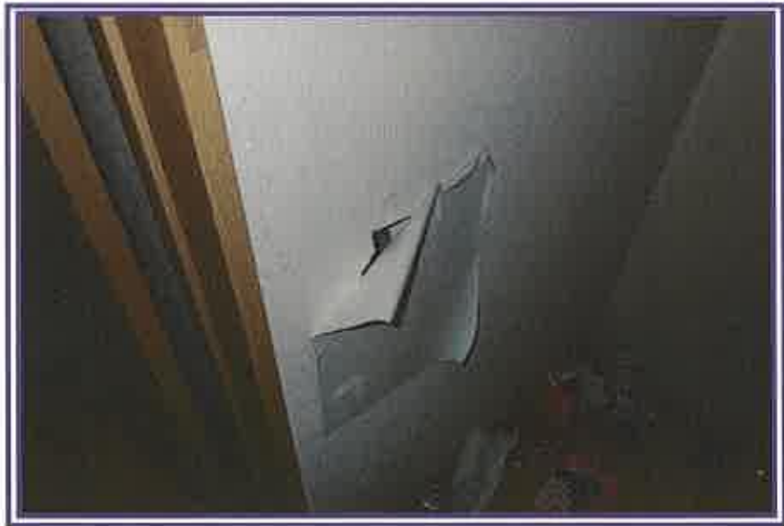
壁の損傷箇所(穴)を、紙で塞いでいる状況を撮影したもの(2階廊下)
