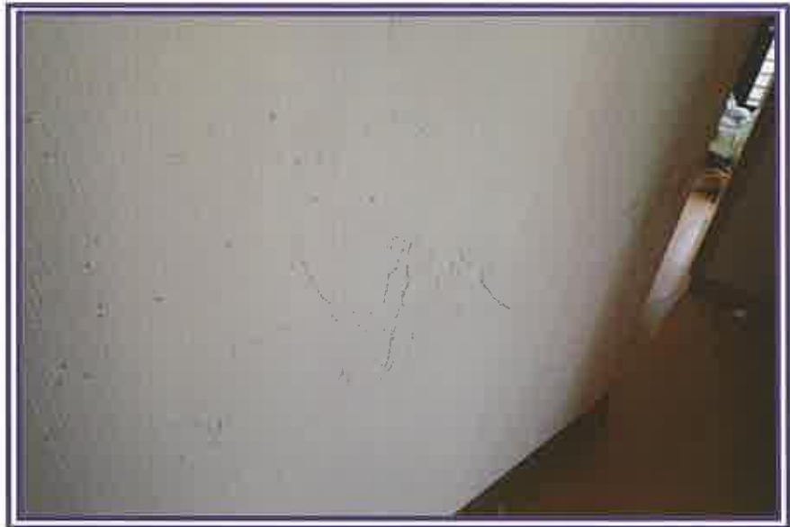
クロス汚れが認められる状況を撮影したもの(2階廊下)
