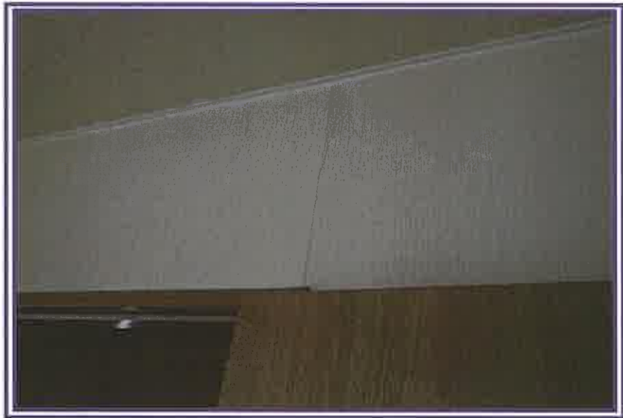
クロスに損傷が認められる状況を撮影したもの(リビングダイニング)
