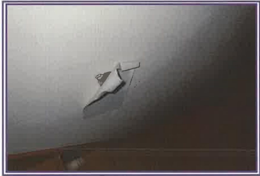
壁の損傷箇所(穴)を、紙で塞いでいる状況を撮影したもの(1階階段付近)
