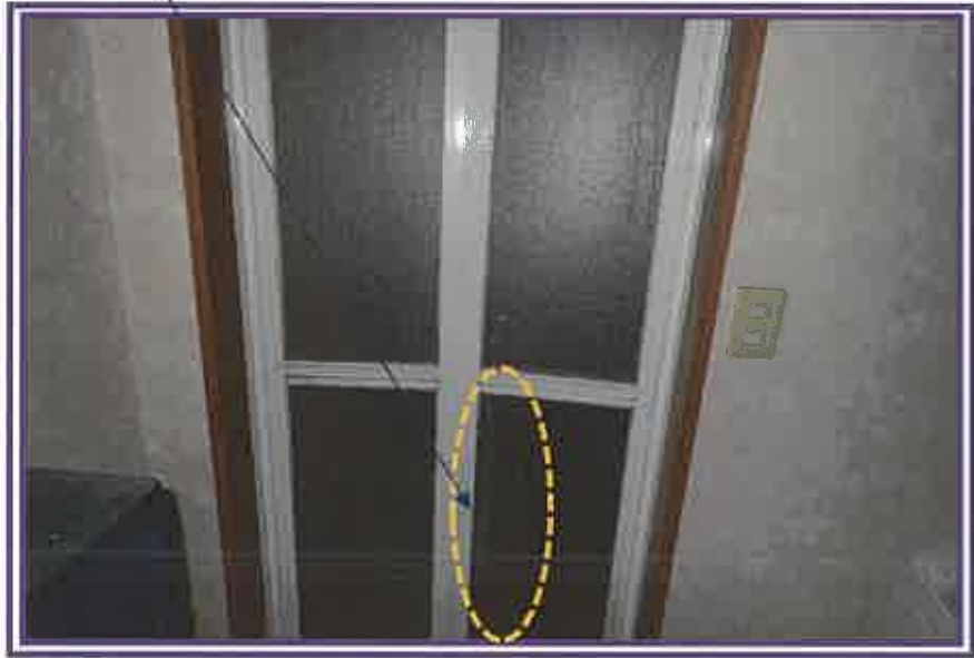
浴室入口ドア(アクリル板部分)に損傷が認められる状況を撮影したもの
