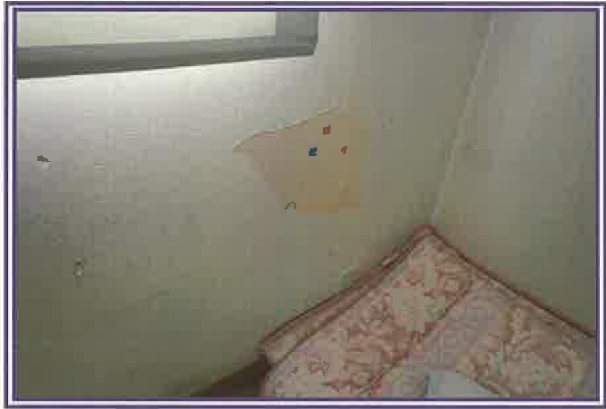
クロス汚れ、損傷が認められる状況を撮影したもの(洋室4)
