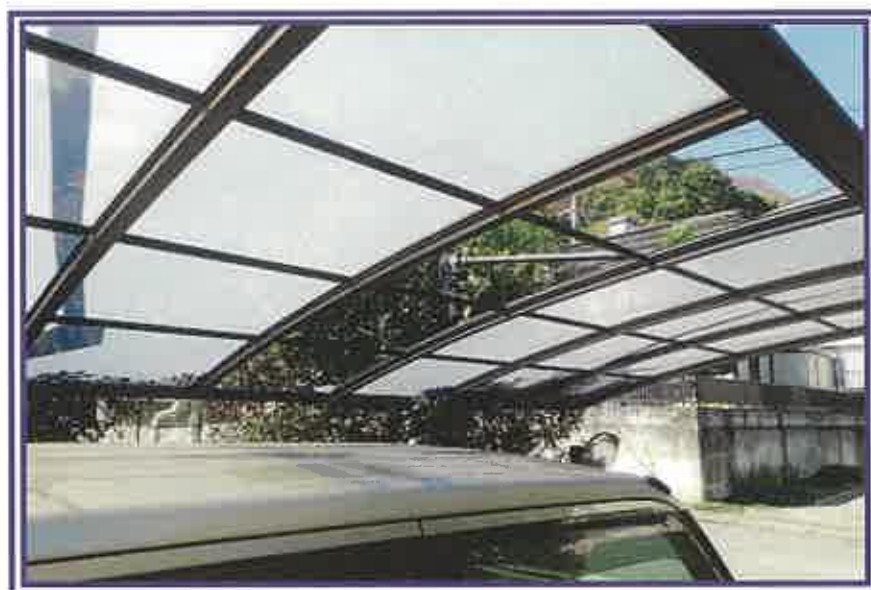
カーポートの屋根に損傷が認められる状況を撮影したもの
