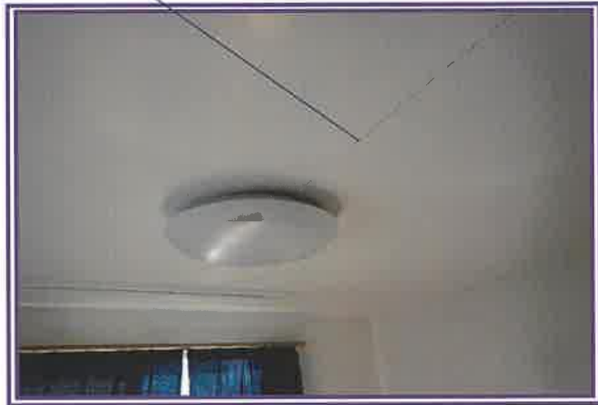
洋室3の天井に、クラックが認められる状況を撮影したもの
