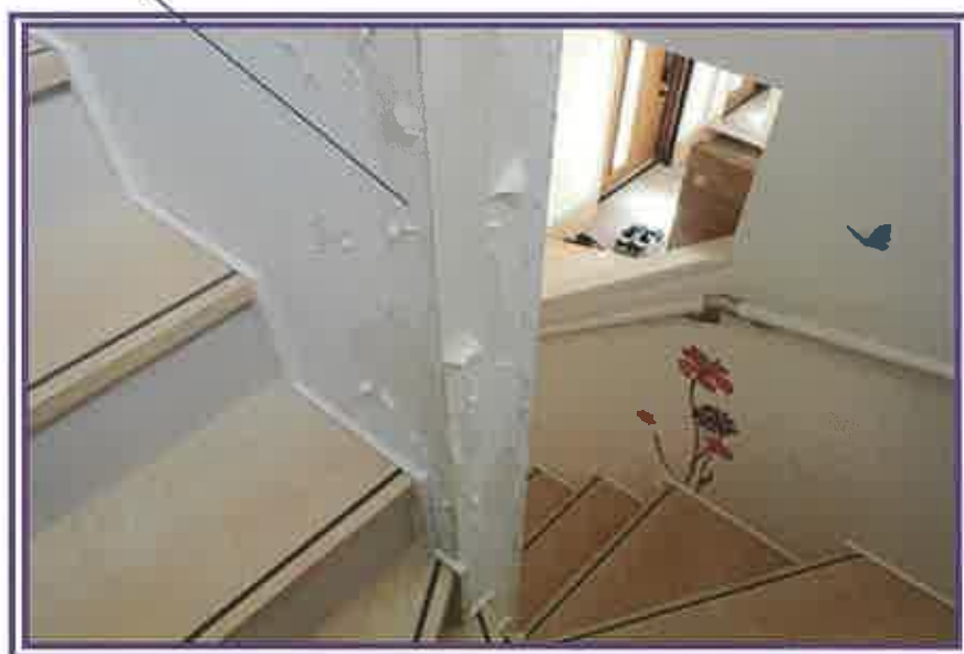
階段の壁紙に、損傷が認められる状況を撮影したもの
