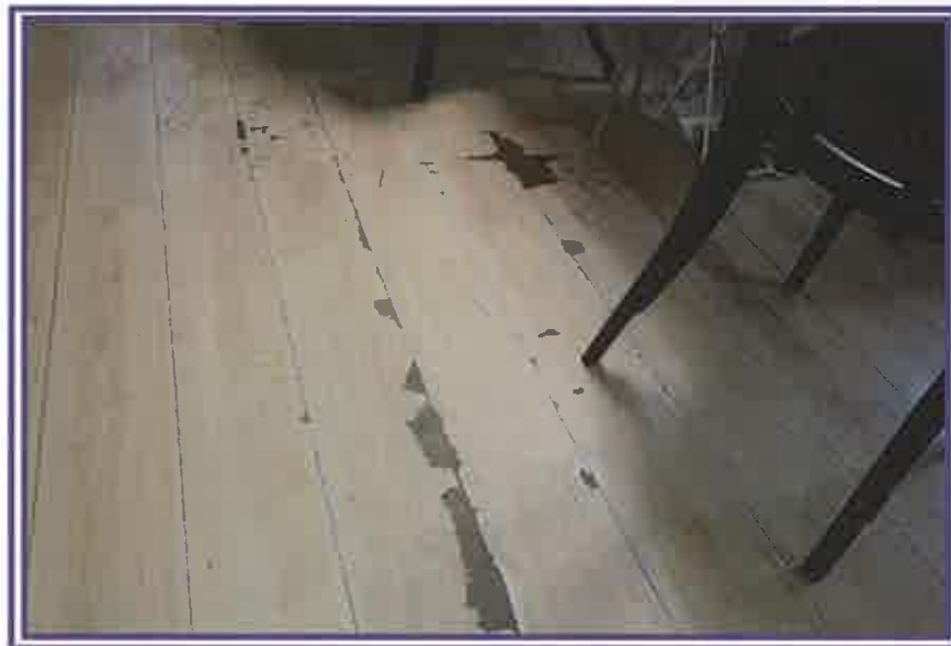
ダイニングの床に、損傷が認められる状況を撮影したもの
