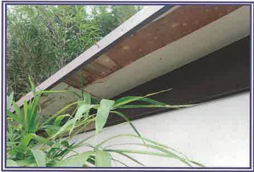
庇の板に損傷が認められる状況を撮影したもの(物件4未登記附属建物)
