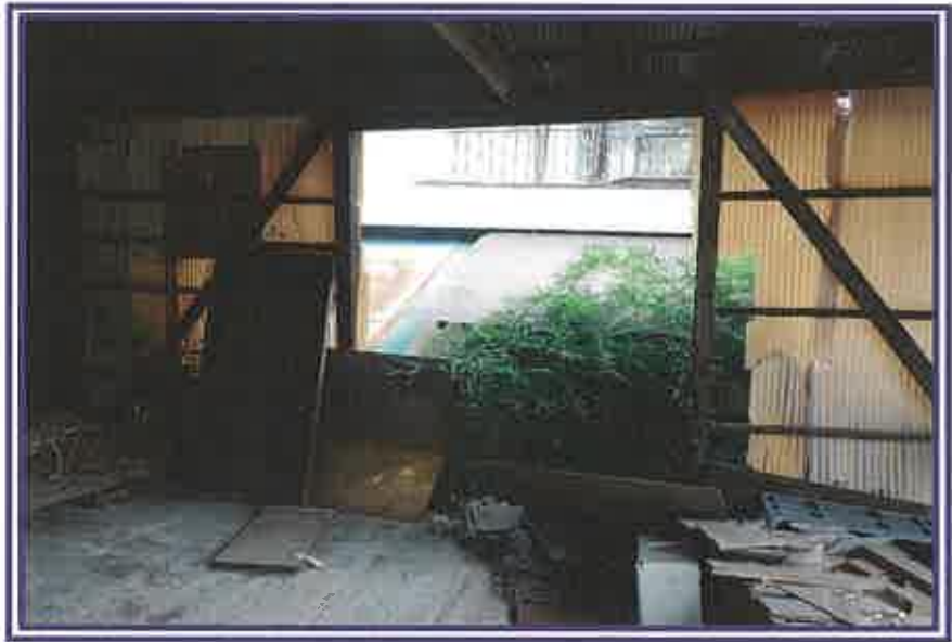
壁の損傷が認められる状況を撮影したもの(物件4附属建物符号1)
