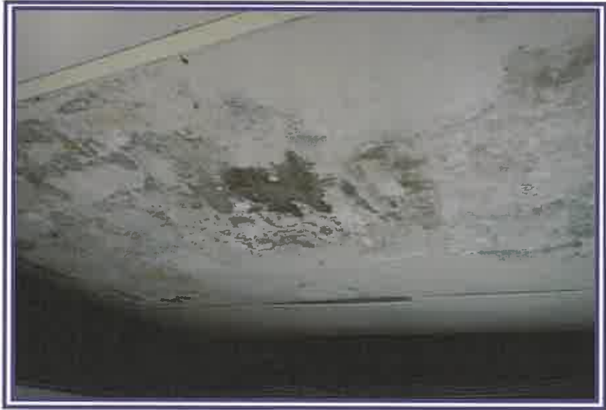
天井に、雨漏り跡や損傷が認められる状況を撮影したもの (物件4未登記附属建物)
