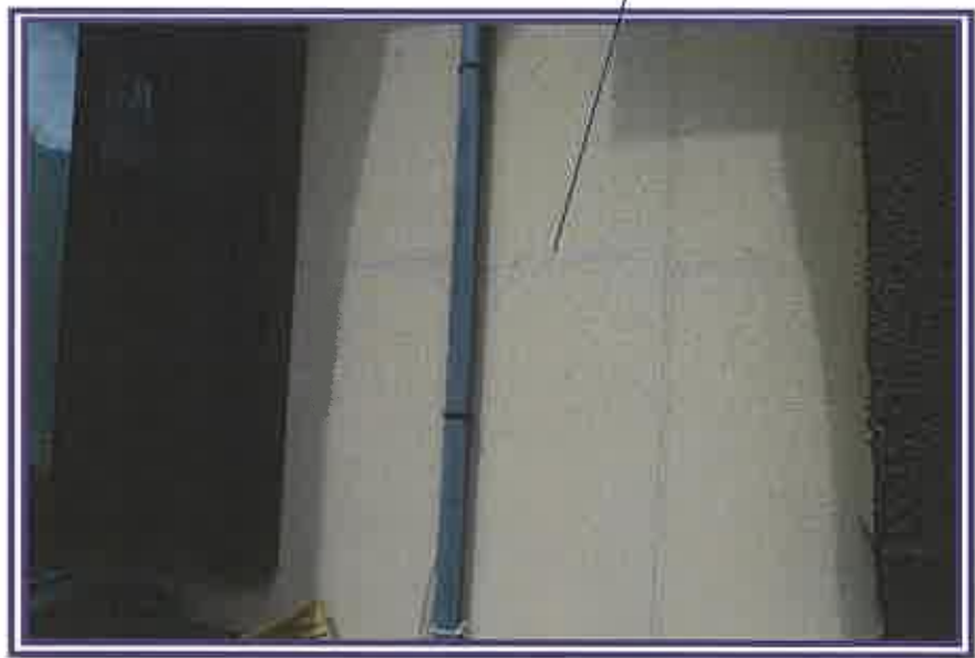
外壁の損傷箇所を撮影したもの(物件3(居宅))
