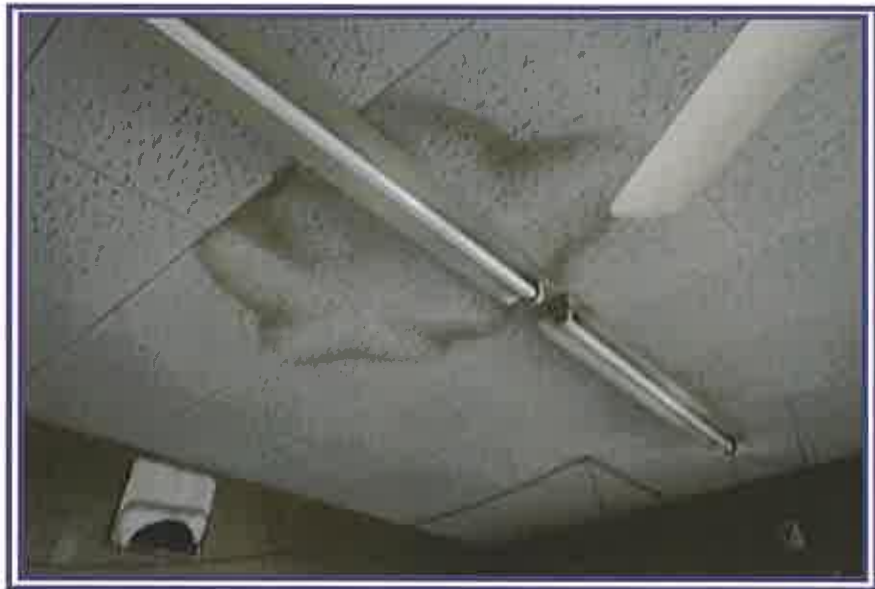
雨漏り跡を撮影したもの(物件4主である建物)
