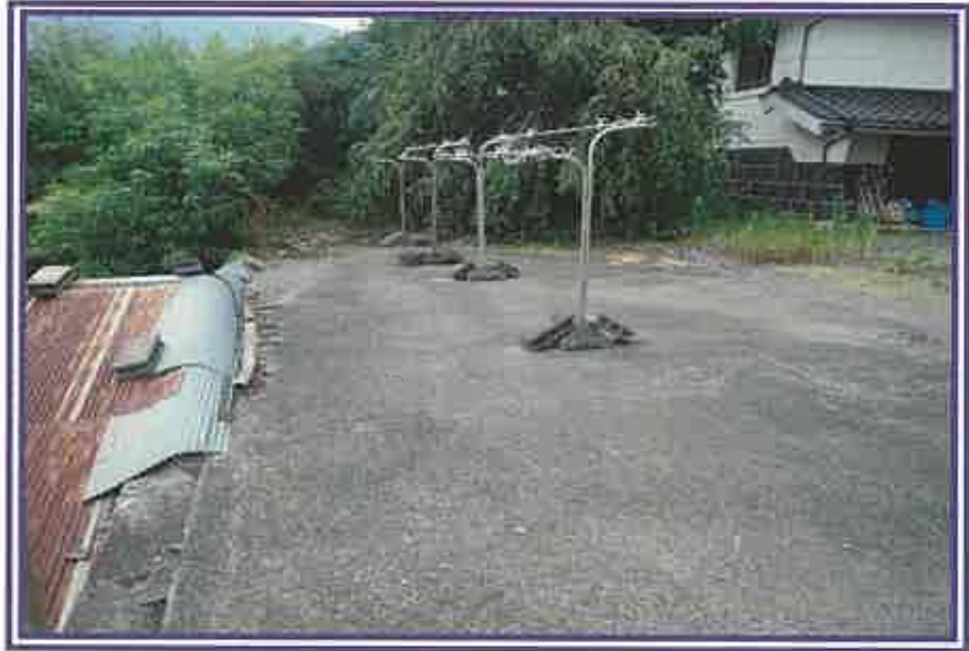
木・コンクリート造の構築物(高床式倉庫)の屋上部分を撮影したもの
