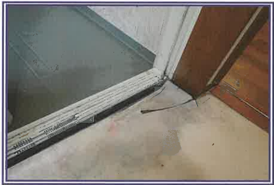
浴室入口付近の、床の腐食箇所を撮影したもの(物件3(居宅))
