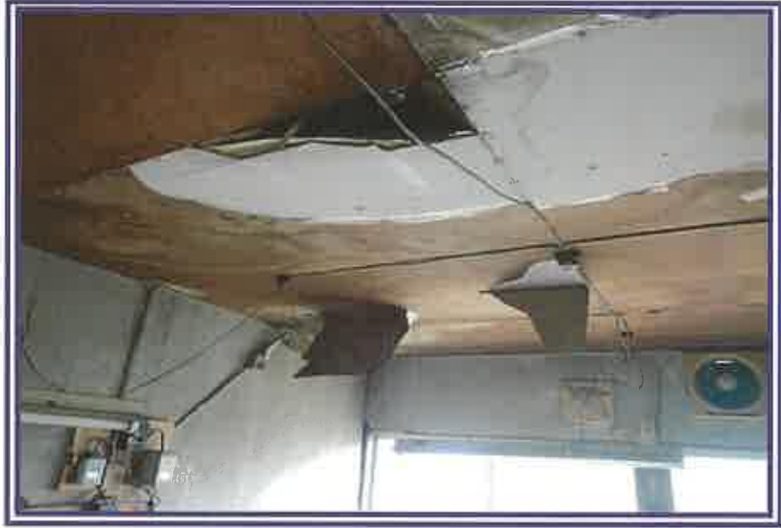
天井の損傷箇所を撮影したもの(物件4主である建物)
