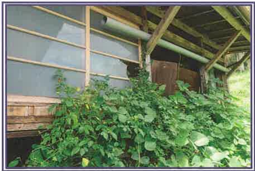
倉庫2階の窓ガラスに破損が認められる状況等を撮影したもの (物件2未登記附属建物)
