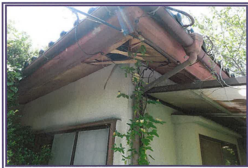
軒下の損傷が認められる箇所及びその周辺を撮影したもの(物件7の建物)
