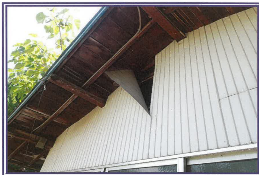
外壁の損傷が認められる箇所及びその周辺を撮影したもの (物件8の未登記附属建物1「倉庫」)
