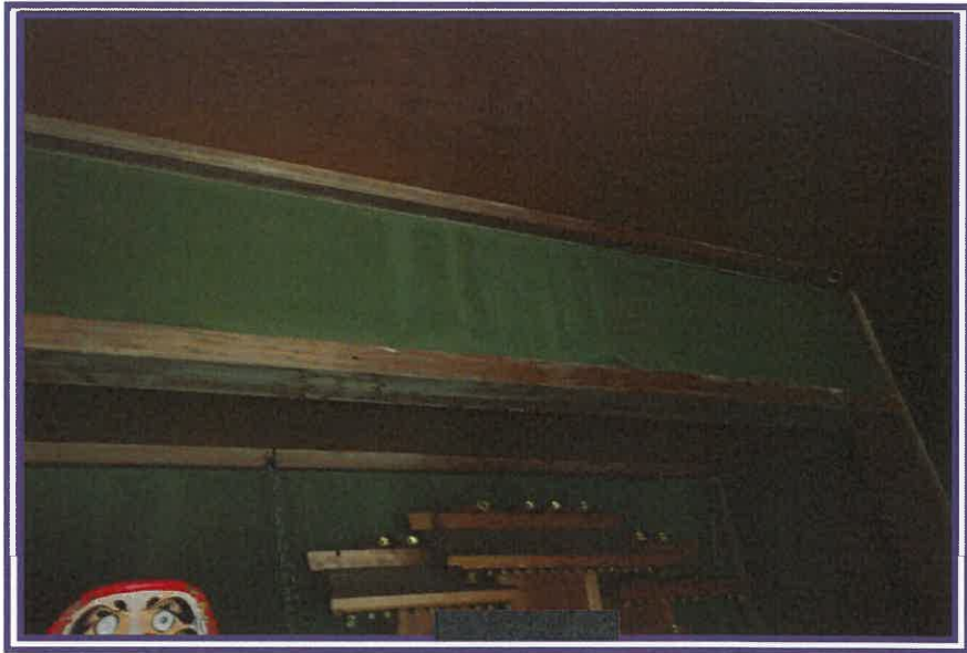
雨染みが認められる箇所及びその周辺を撮影したもの(物件7の建物の「和室1」)
