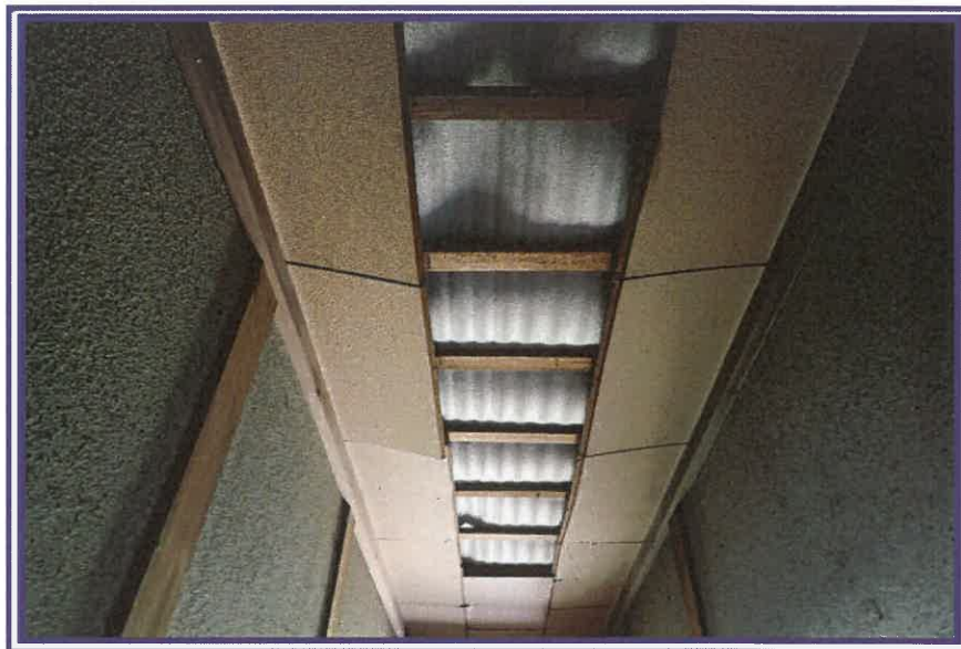
天井の損傷が認められる箇所及びその周辺を撮影したもの (物件8の主である建物の廊下)
