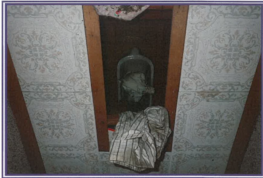
天井の損傷が認められる箇所及びその周辺を撮影したもの (物件7の建物の「洗面所・脱衣所」)
