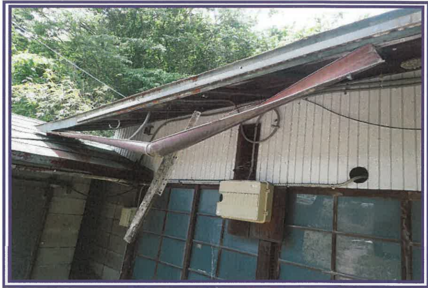
雨樋の損傷が認められる箇所及びその周辺を撮影したもの (物件8の未登記附属建物1「倉庫」)
