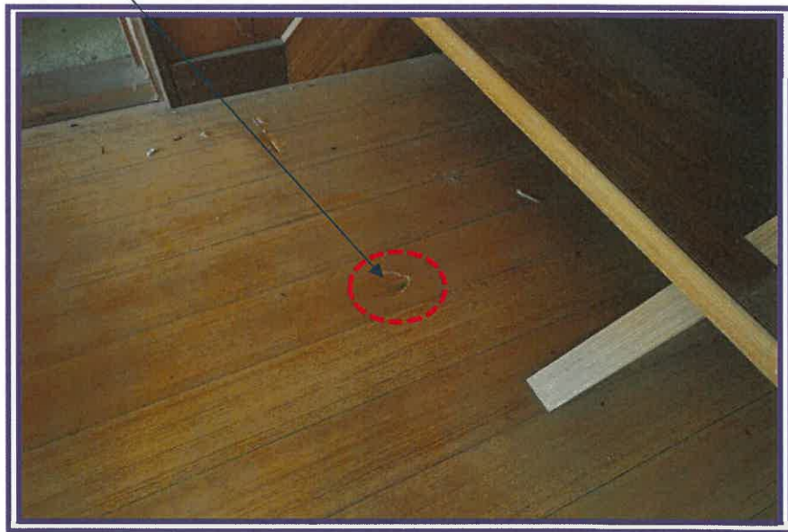
床の損傷が認められる箇所及びその周辺を撮影したもの(物件7の建物の1階階段付近)
