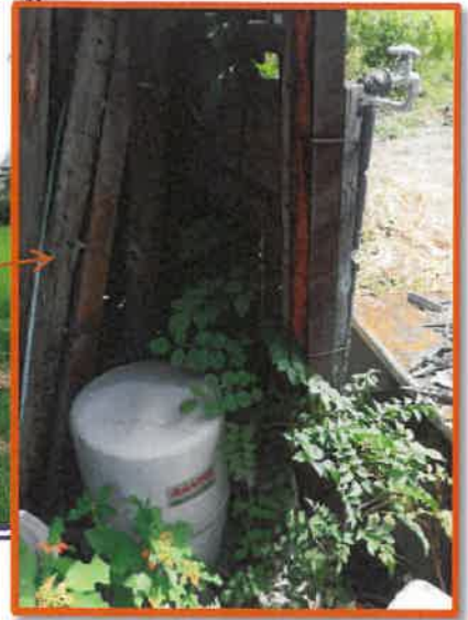
地下水汲上ポンプ
