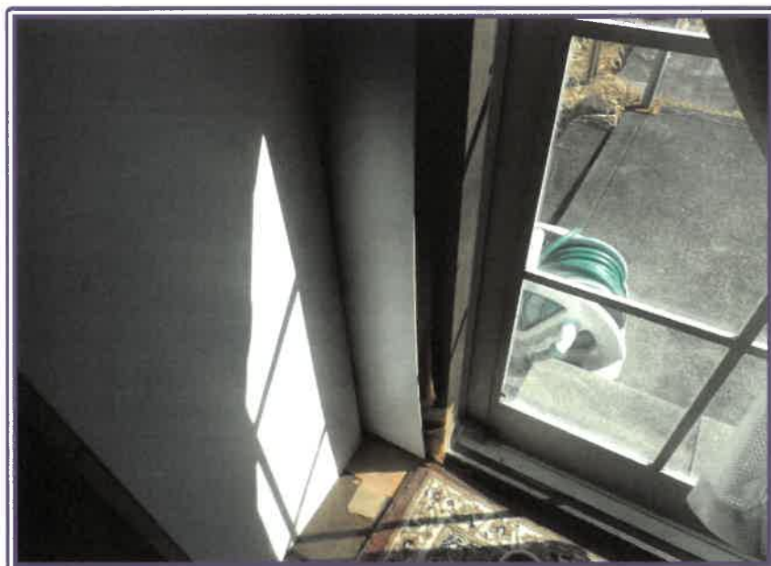
漏水による損傷箇所
