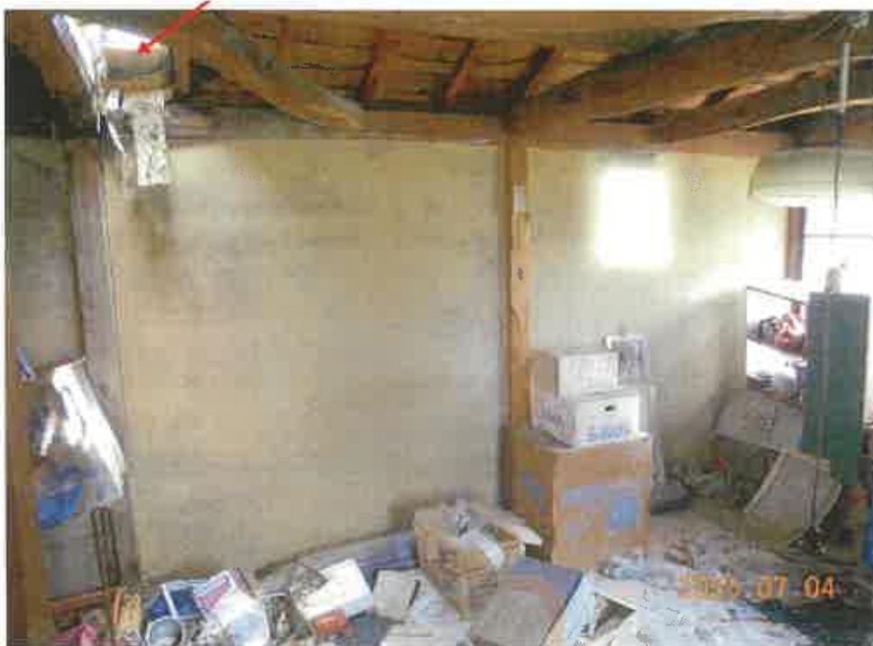
写真 2 1 本件建物の附属建物符号 1 の 2 階和室天井及び屋根の一部の 破損箇所（穴が空いている）
