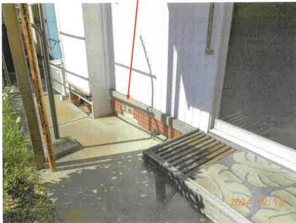
写真 2 7 物件 3 の建物の外壁の一部破損箇所（撮影箇所の図示は省略）
