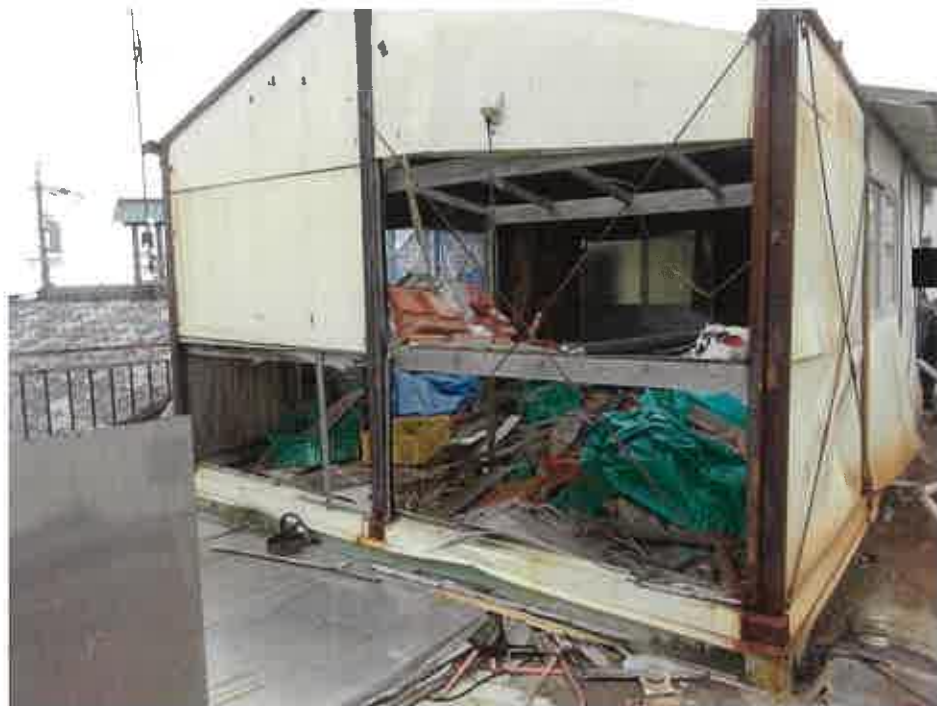
(13) 屋上に存在するプレハブ (動産)
