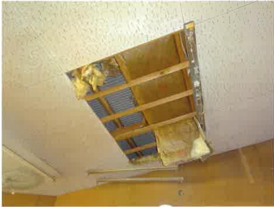
(9) 天井破損部分
