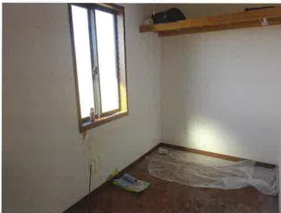
クロスの剥がれ（破れ）
