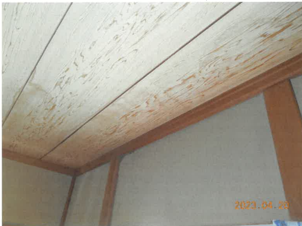
写真2 1 物件6の建物1階南東側和室の天井部分の雨漏り跡
