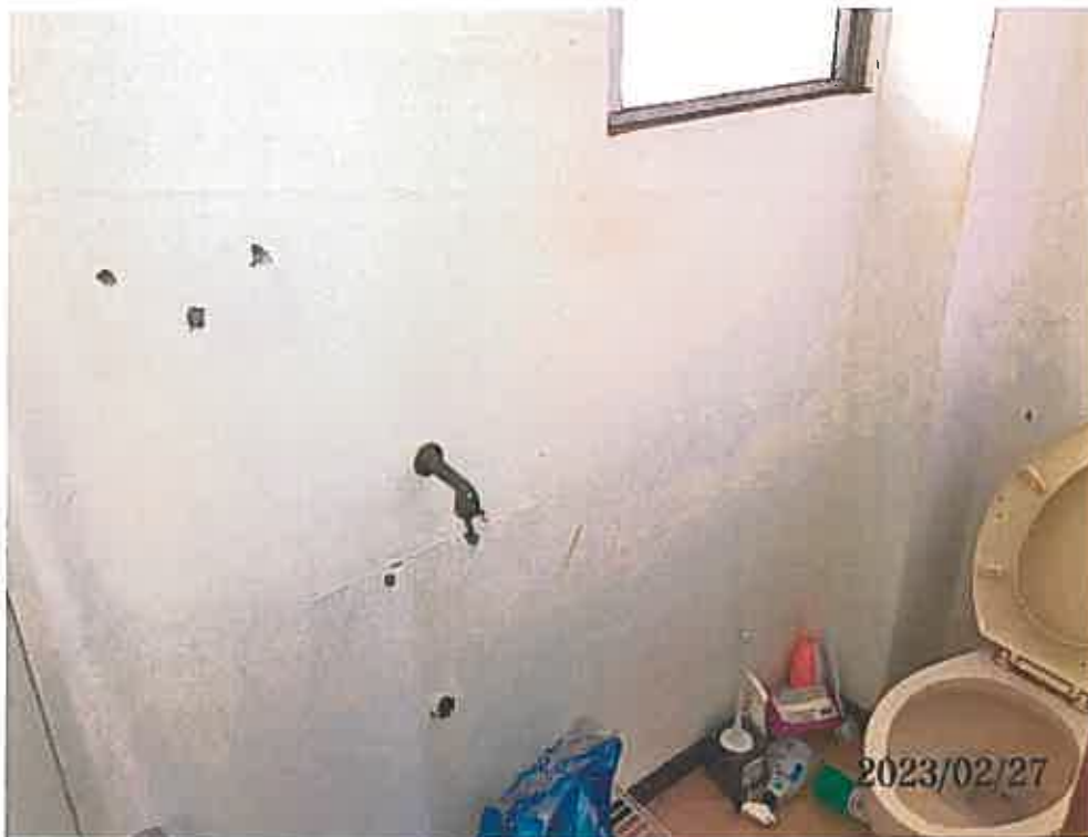
写真25 本件マンション430号室上階トイレ内の洗面台が不存在
