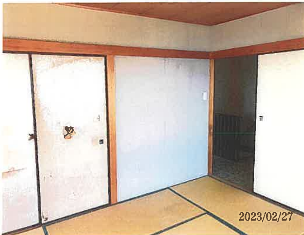
写真 2 4 本件マンション 4 3 0 号室上階北側和室の内壁の水漏れ跡、襖の破損
