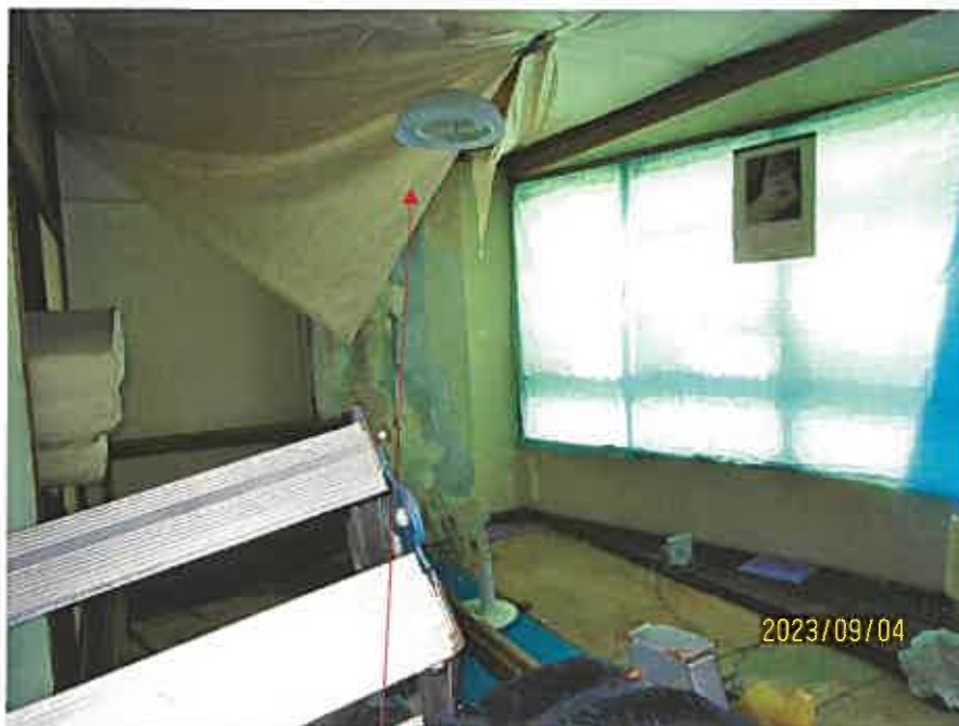
配管の水漏れ
