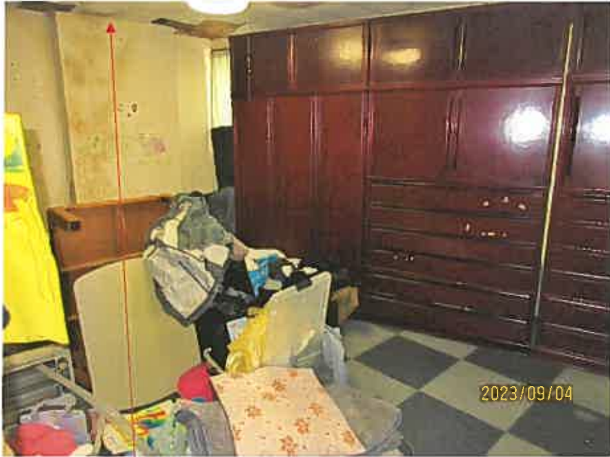
配管の水漏れ
