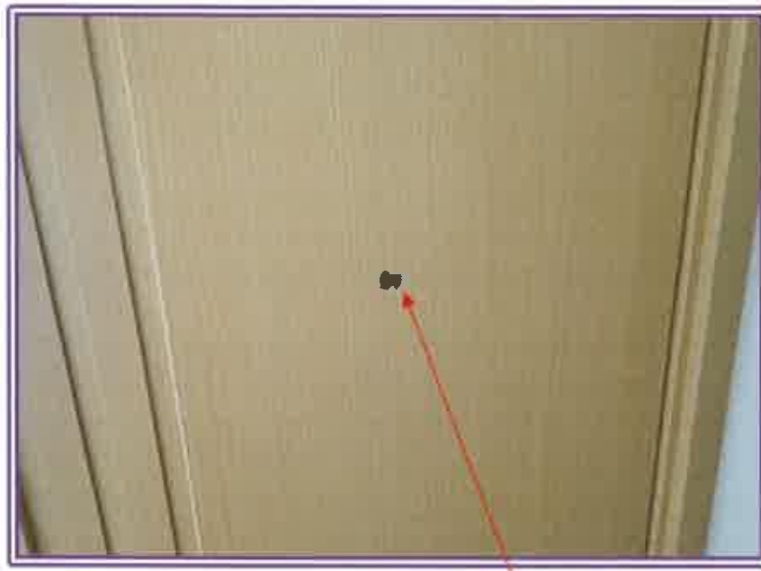
2階トイレドアの陥没箇所
