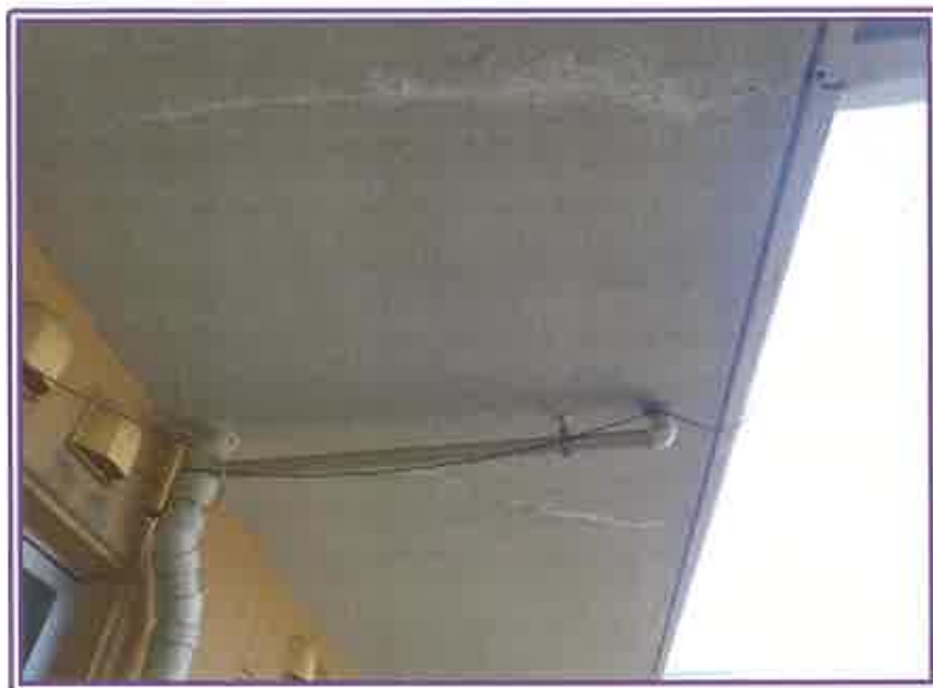
職員玄関付近屋外天井に認められるクラック
