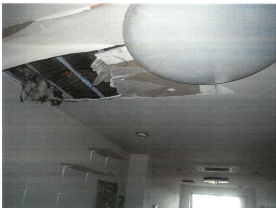
建物内の状況（天井の破損）
