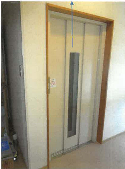
エレベーター
