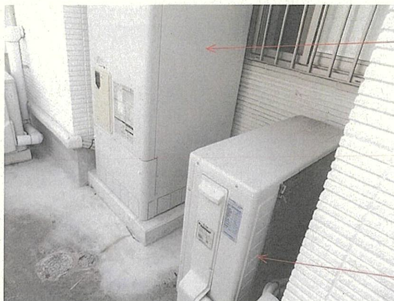
貯湯ユニット
