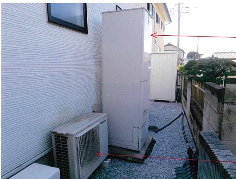
貯湯ユニット
