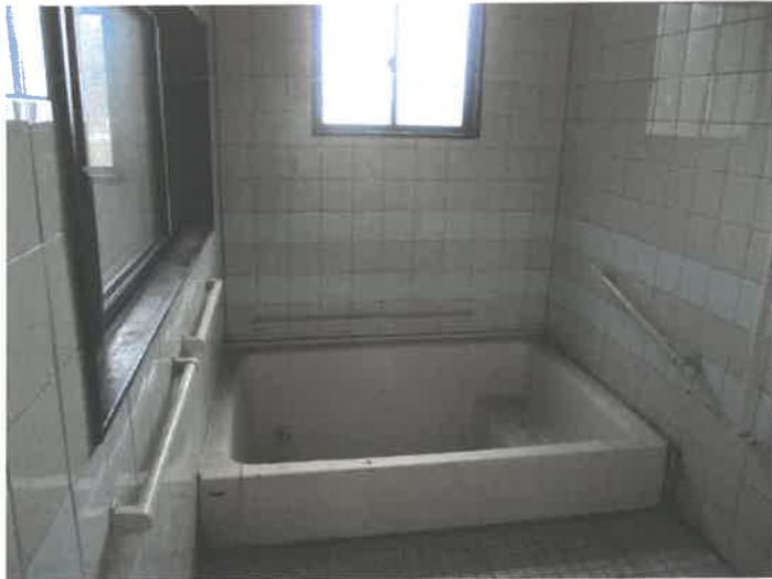
写 真 7 (物件5主である建物浴室)
