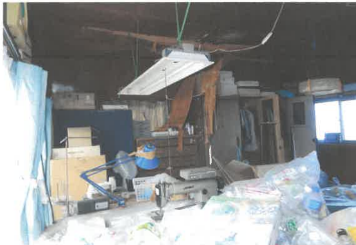
附属建物符号1 物置(天井が落ちている状況)
