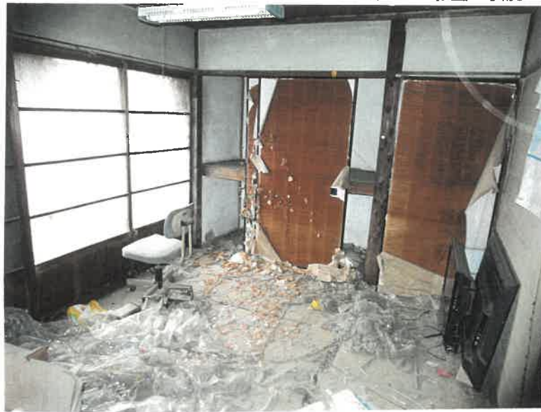
物件5 和室の状況
