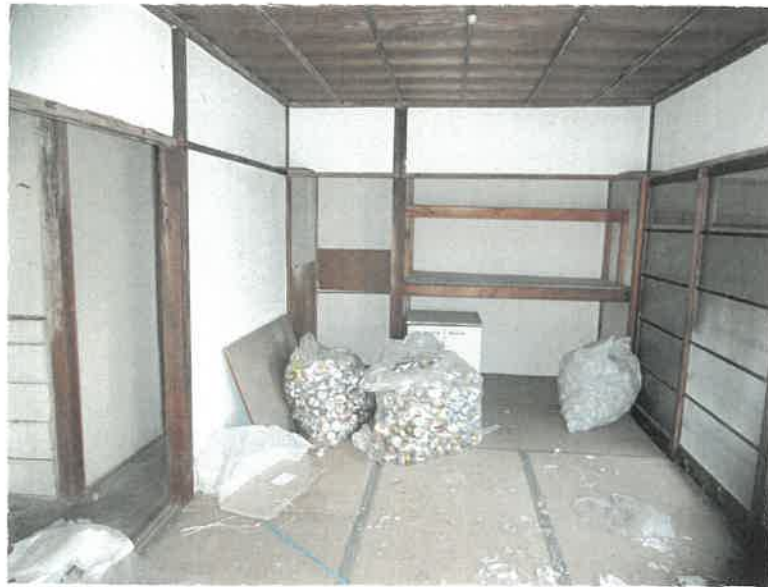
物件8 和室の状況
