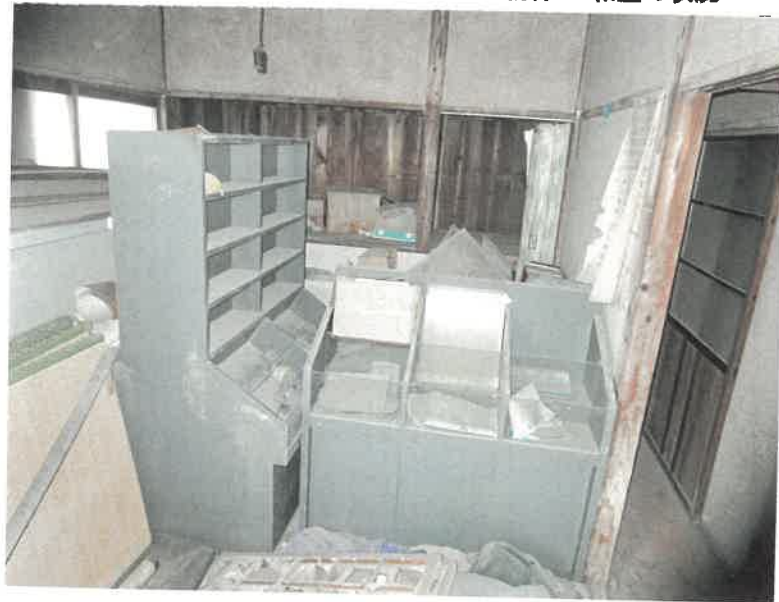
物件4 和室の状況
