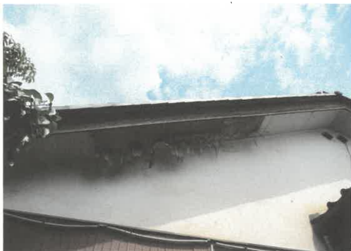
写 真 6 (物件2 附属建物符号2 外壁破損箇所)
