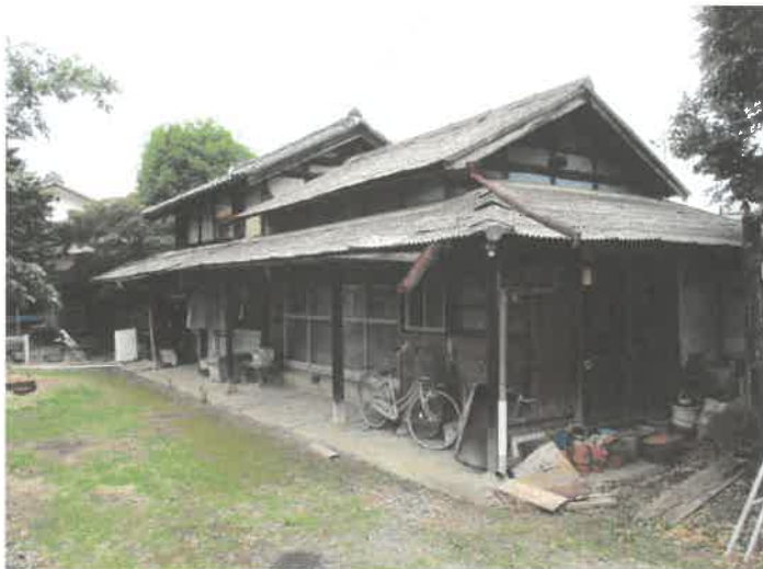
写 真 5 (物件3 建物軒下破損箇所)
