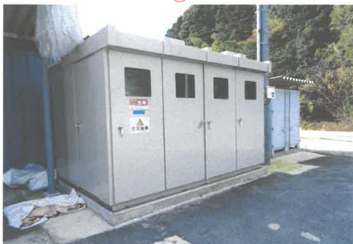
キュービクル(変電設備)
