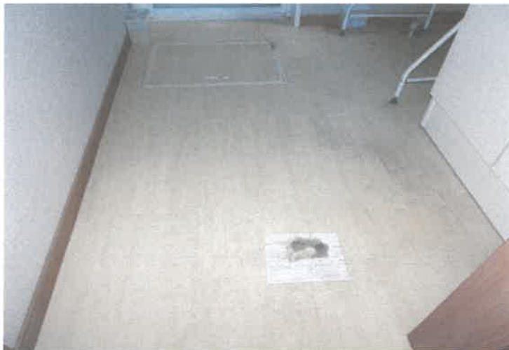
洗面台前の床の状況(犬に掘られた痕跡)
