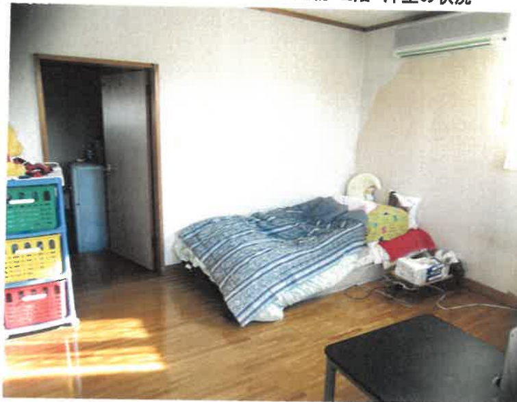
物件2主である建物 2階 洋室の状況
