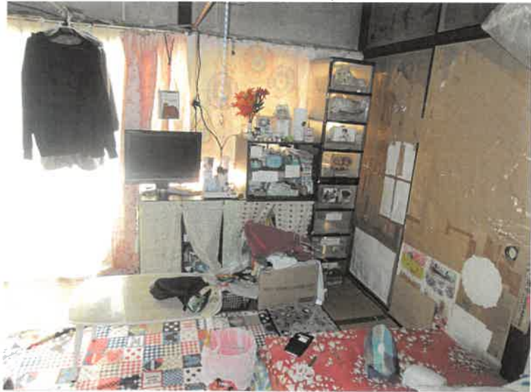
物件4 和室の状況
