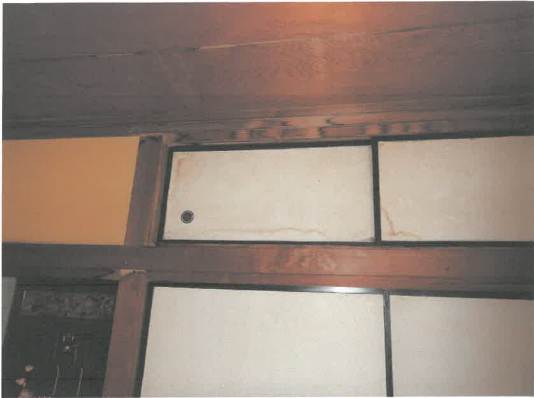
⑤ 雨漏り跡
