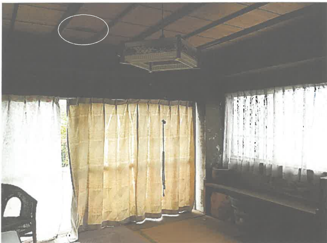
円内は雨漏り痕が推定されるシミ
