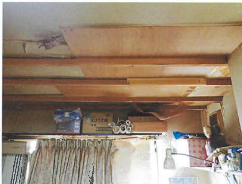
302号室（雨漏り部分）㊺
