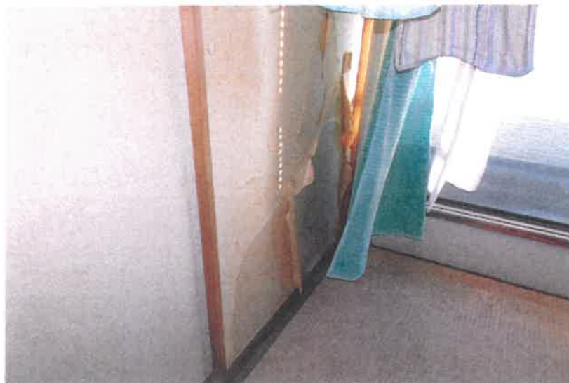
2階和室の襖及び畳の損耗
