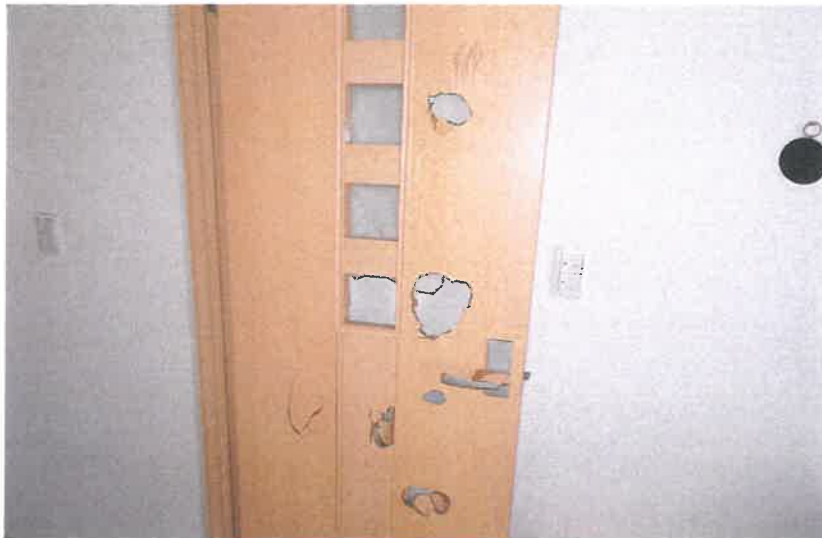
2階中央洋室ドア損傷
