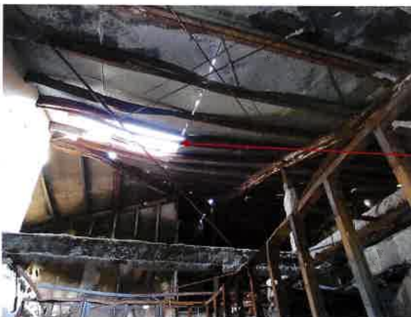
⑮ 屋根が欠落
