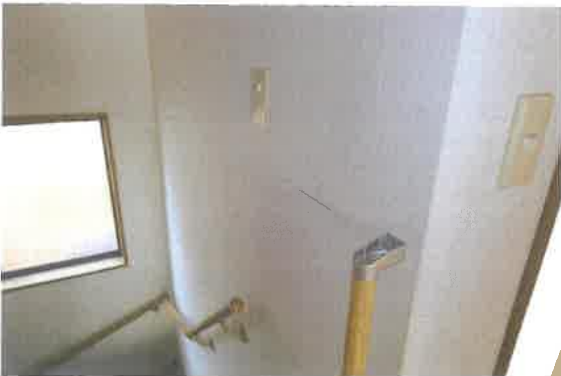
2階段付近壁の損傷
