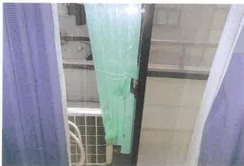
2階洋室(3)サッシガラスの割れ
