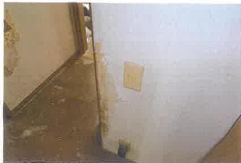
2階廊下の壁クロスの損傷及び床の汚れ
