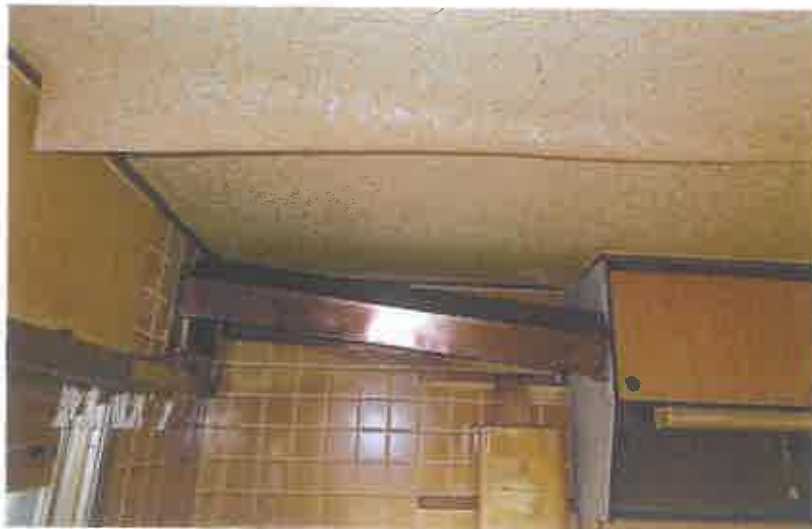
換気扇フード脱落、天井クロス剥がれ
