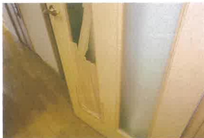
LD入口扉ガラス割れ
