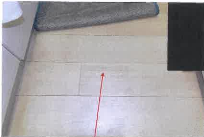
キッチン床の亀裂
