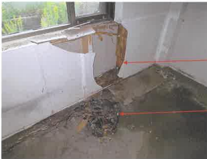
⑮ 内壁の破損
