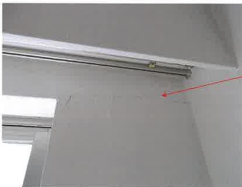
②④ 内壁クロスの亀裂
