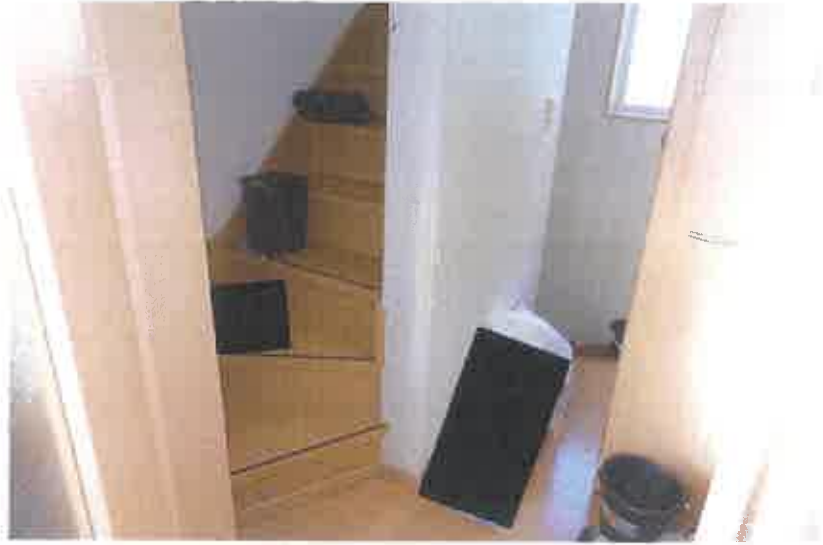
壁のクロス損傷
