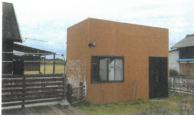
附属建物符号1外壁の落書き
