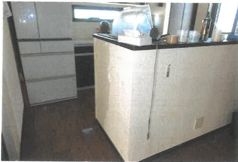
キッチンカウンターの剥がれ・汚れ・落書き
