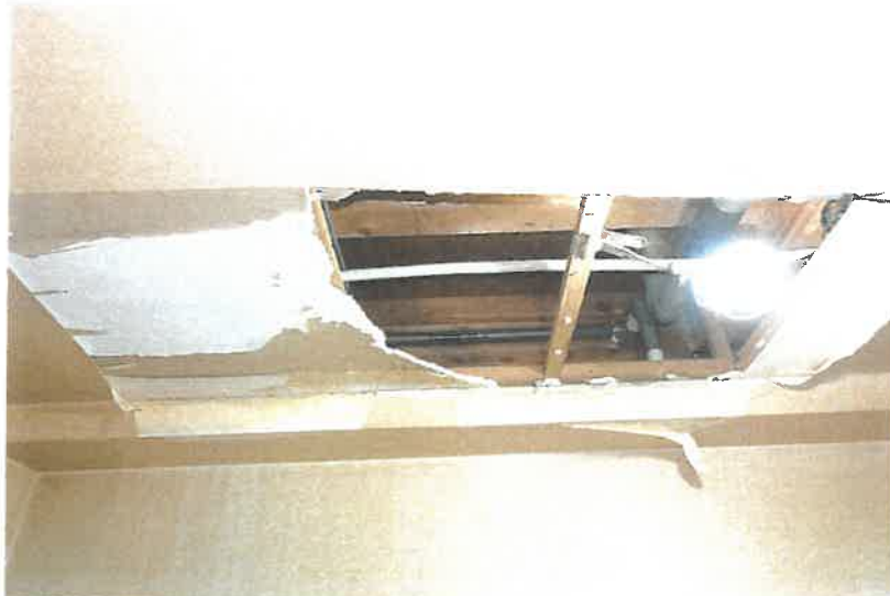
1階DK天井の損傷
