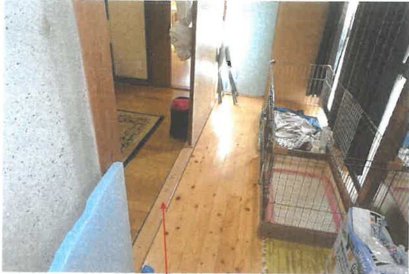
敷居の溝がない
