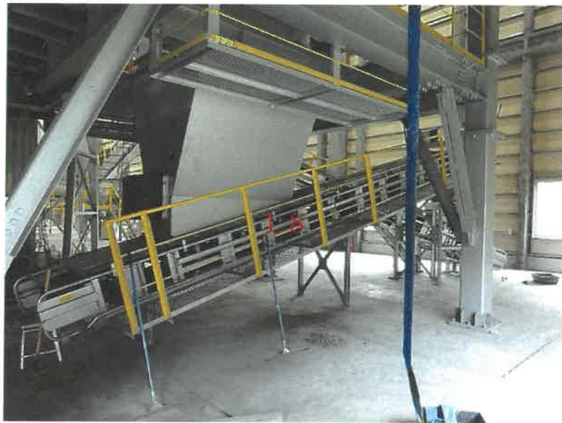
機械器具 (No.19 : 排出コンベヤ) ㉑
