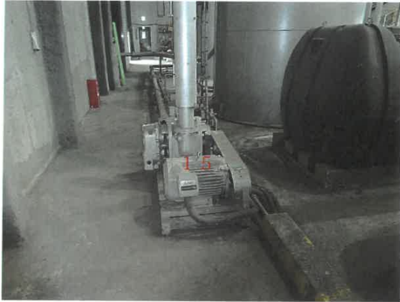
機械器具 (No.16 : ロータリフィーダ) (No.17 : カットダンパー) ㉑
